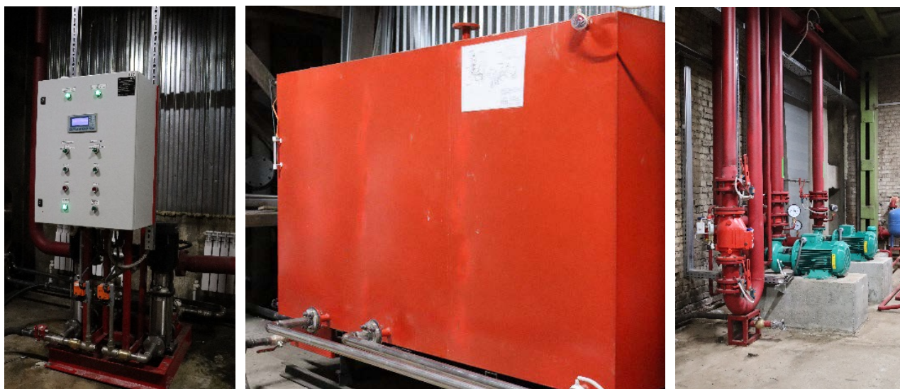
Система автоматической установки пенного пожаротушения
