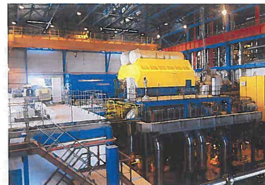
Машинный зал Абаканской ТЭЦ. Турбогенератор ТВФ-125-2У3 в составе турбоагрегата
