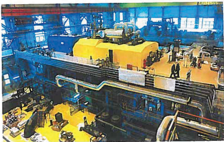
Машинный зал Томь-Усинской ГРЭС. Турбогенератор ТВФ-125-2У3 в составе турбоагрегата
