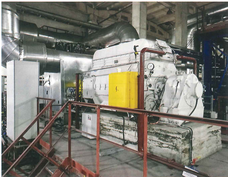
Турбогенератор ТГП-6,3-6000-2У3 в машинном зале Южной тепловой станции (г. Рубцовск)
