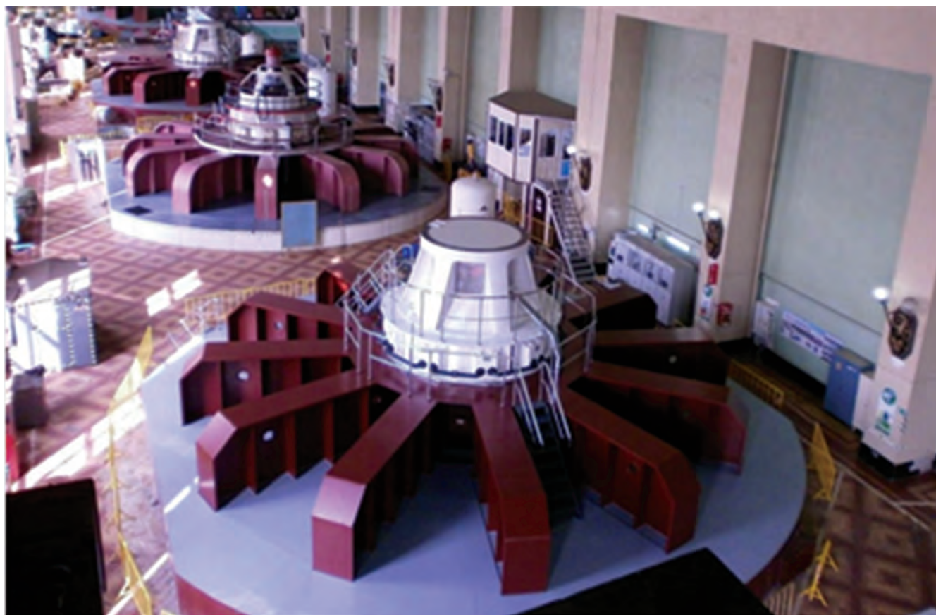
Гидрогенератор на Усть-Каменогорской ГЭС
