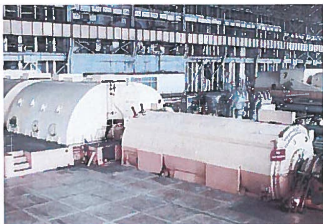
Турбогенератор ТВМ-500 производства НПО «ЭЛСИБ» ОАО на Рефтинской ГРЭС
