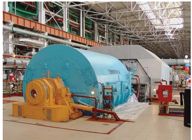
Фото 1. Турбогенератор ТФ-63-2У3, маизал Томской ГРЭС-2
