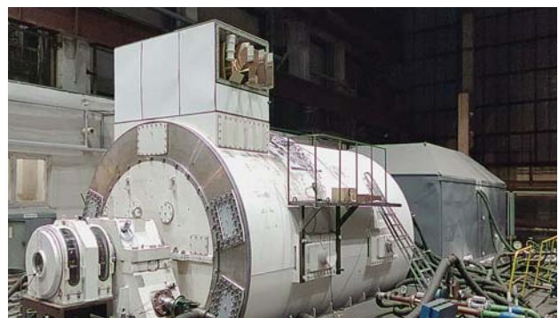
Фото 2. Турбогенератор ТФ-90Г-2УЗ на испытательном стенде
