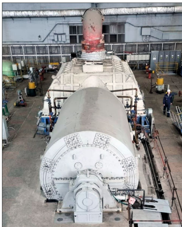
Турбогенератор ТВФ-165В-2У3 ст. № 2 в машинном зале Иркутской ТЭЦ-10
