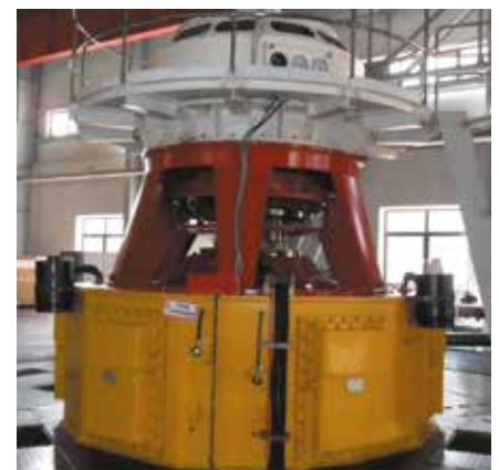
Рис. 1. Машинный зал Головной ГЭС
