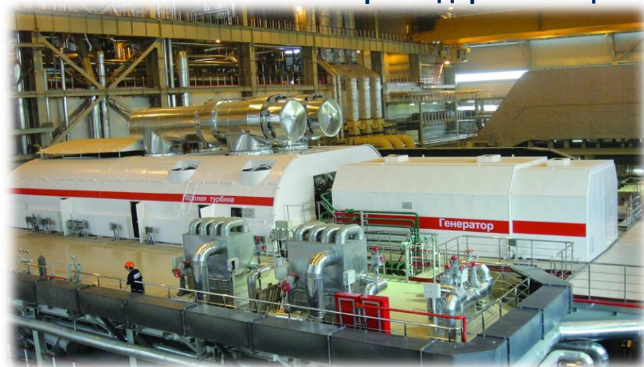
Турбогенератор ТФ-160-2У3, машзал Краснодарской ТЭЦ
