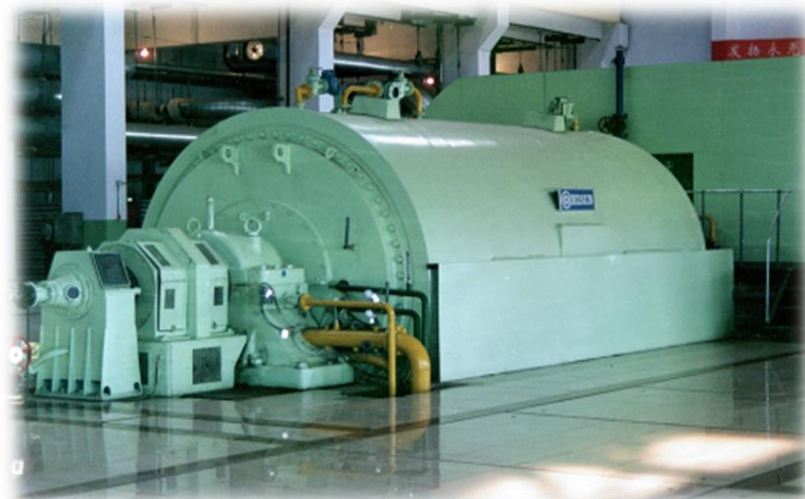
Турбогенератор ТВМ-160, машзал ТЭЦ Сигу
